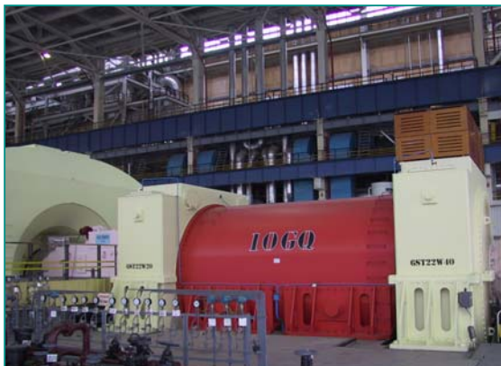
Машинната зала на VI блок
