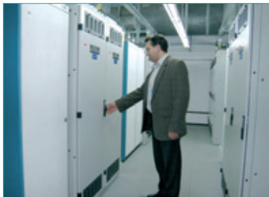
Шкафове с контролери на УКТС – Ovation
