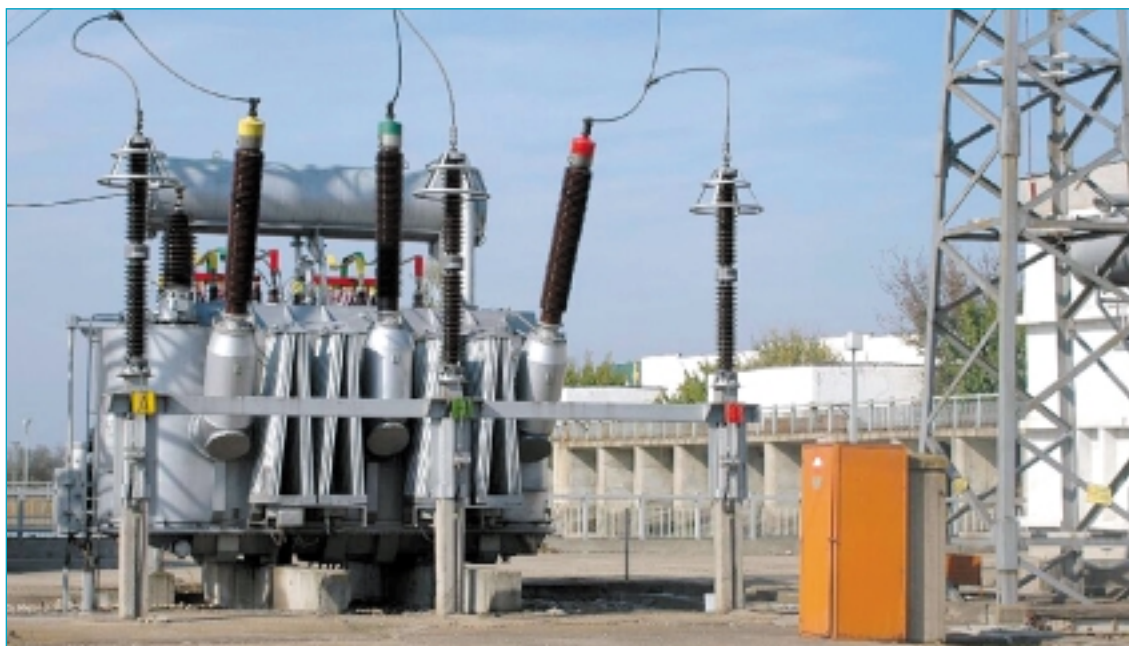
Открита разпределителна уредба на Бреговата помпена станция
