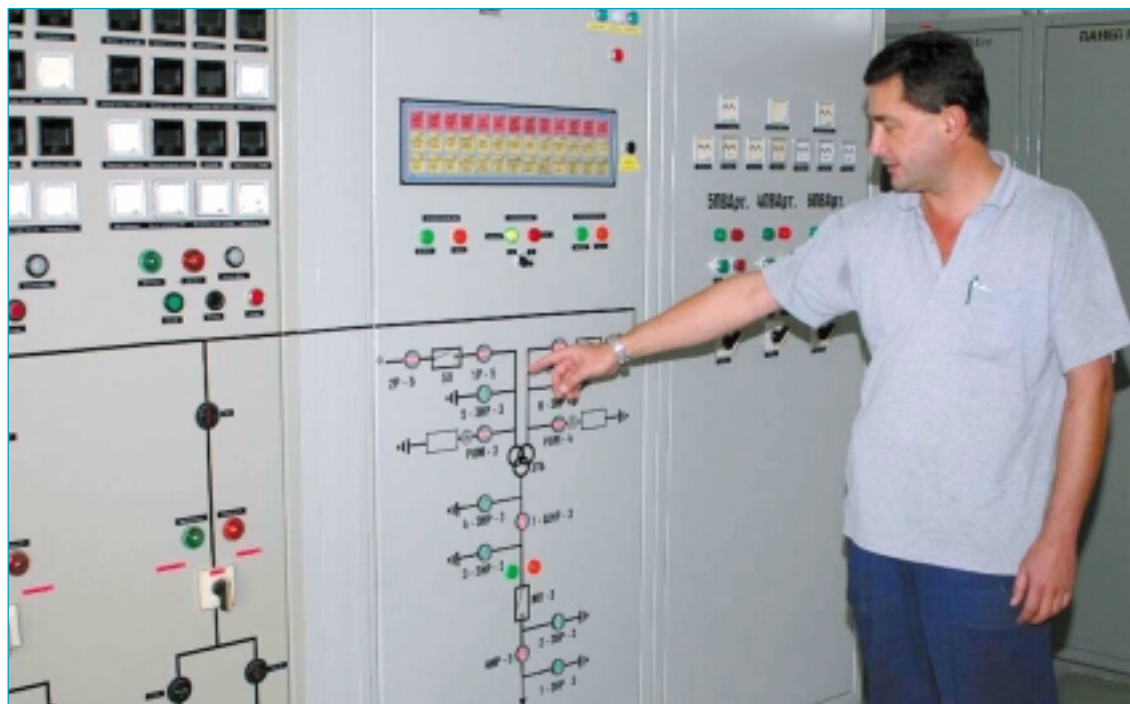
Модернизиран панел за управление и сигнализация на силов трансформатор
