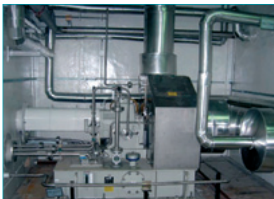
Турбовентилаторът на системата за филтърна вентилация
