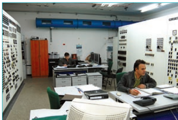
Резервен щит за управление на 6 блок
