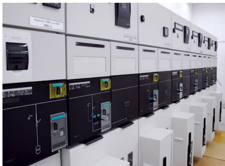
Реконструираната секция "Надеждно захранване"
