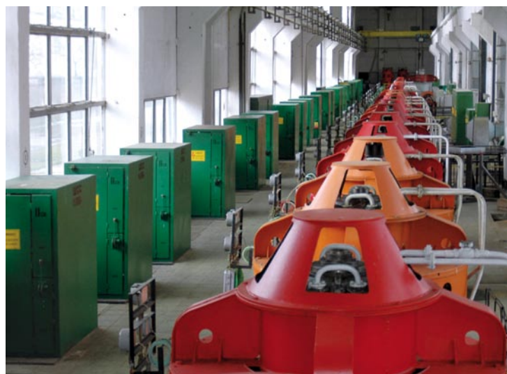
Общата машинна зала на БПС-2 и БПС-3
