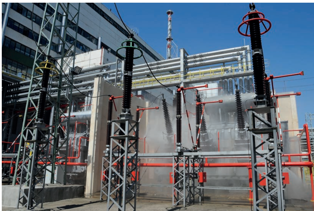
Функционални изпитания на системата за пожарогасене на резервни трансформатори за пети енергоблок
