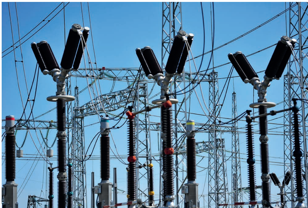
Съоръжение ОРУ 220 kV
